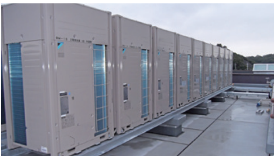
設置された室外機
