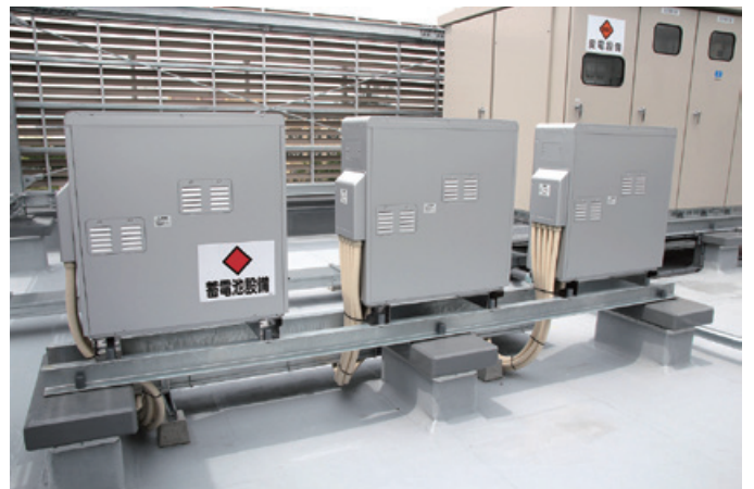
容量7.4kWh×3台の蓄電池が常時フル充電されている
