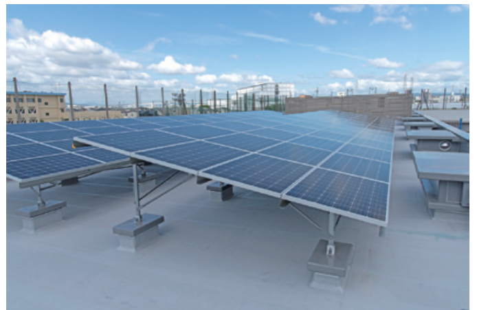
最大出力30kW（単結晶300W×100枚）の太陽光パネル
