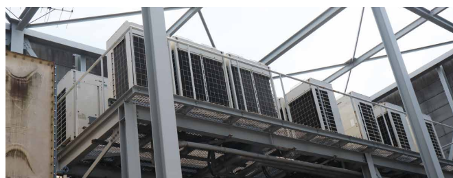
空調設備にローカルコントローラを設置し、24時間365日遠隔監視を行っている
