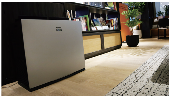
共有スペースに設置されているUVパワフルストリーマ空気清浄機
