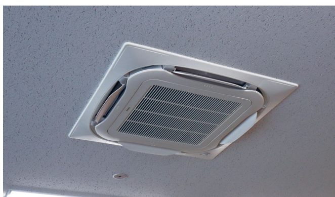
ZEBにより、新たに導入した空調機（上は屋上の室外機、下は室内機）
