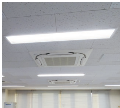
室内機及びLED照明
