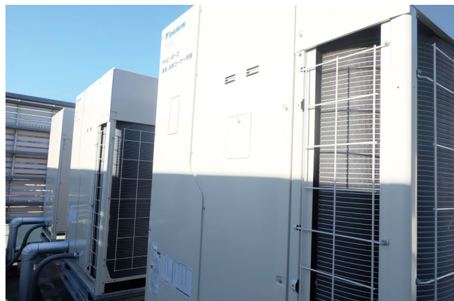
B棟に設置されたダイキン製空調機（室外機）
