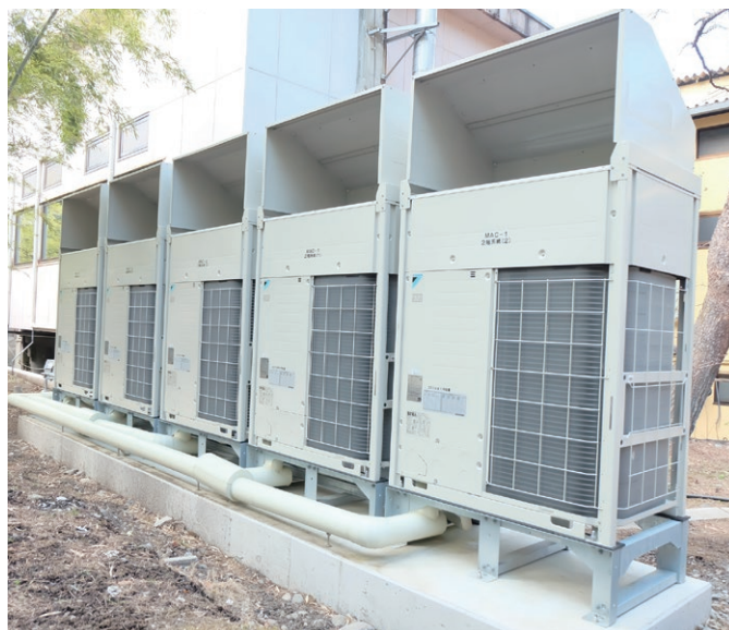
ビル用マルチエアコンにしたことで室外機の設置スペースがコンパクトに
