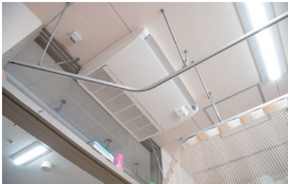
居室には室内機／室外機が1対1のパッケージエアコンを導入
