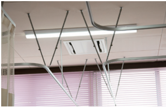
各居室の天井に設置された全熱交換器
