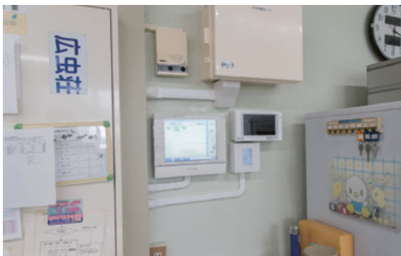
事務室で空調・照明を集中監視・制御できるようになった
