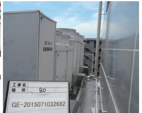
更新前の室外機
