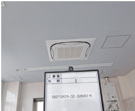
更新された空調
