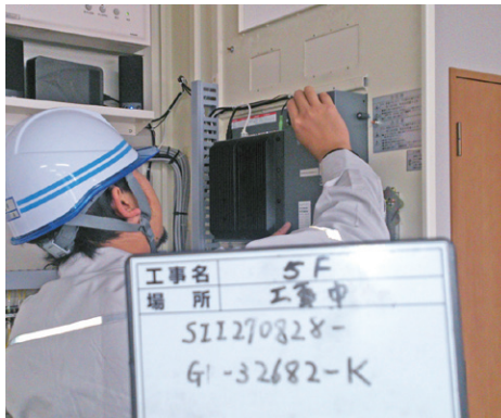
電力管理用に設置されたパルス変換器
