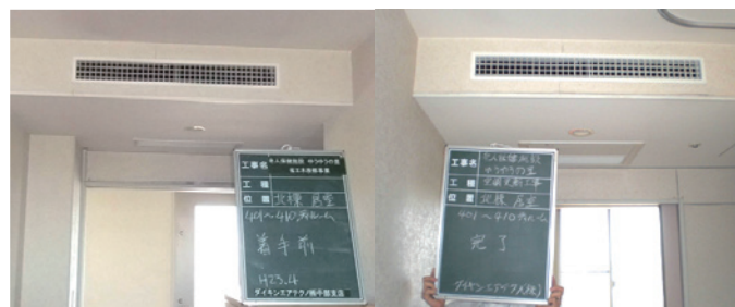
空調更新前（左）と更新後（右）で印象が変わらない空調吹き出し口
