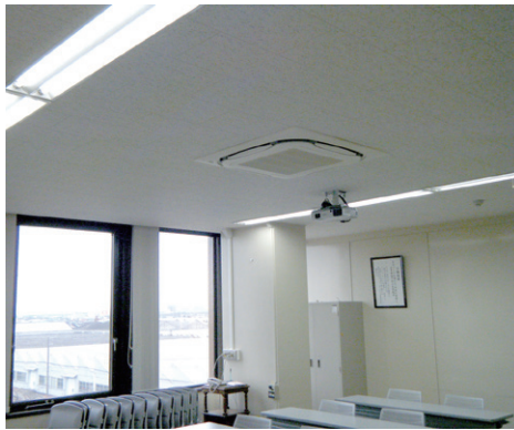
センシングフロア室内機が施工された天井
