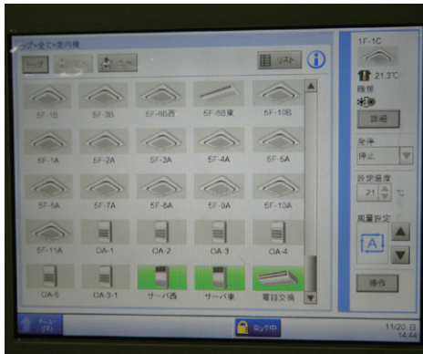
空調機集中監視盤の室内機選択画面
