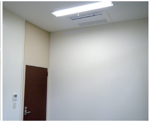
ドア付近に施工されたシングルフロア室内機
