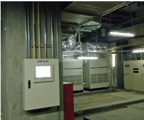
地下機械室に設置された空調機集中監視盤(左手前)と、設備用の大型空調機(右奥)
