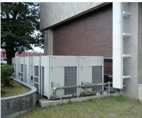
室外機（西側）。配管ダクトは外壁色に合わせて塗装してある
